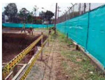
Figura 26. Barreras de contención perimetral.
