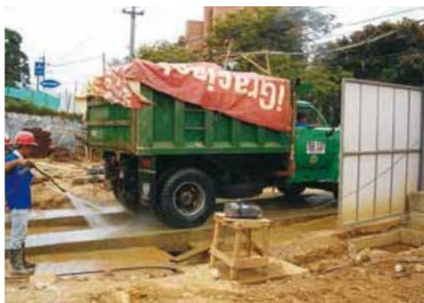
Figura 14. Humedecimiento de accesos.
